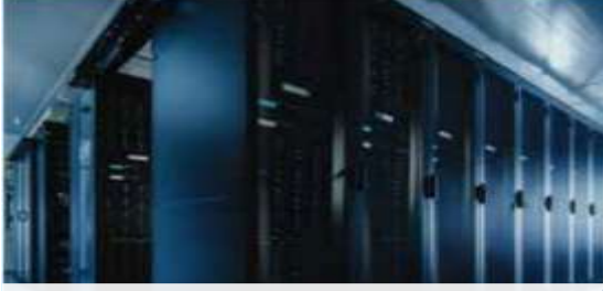
VERİ MERKEZLERİ (DATA CENTER)
